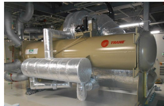
ノンフロン冷媒採用ターボ冷凍機
